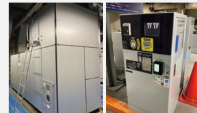
エアハンドリングユニット 駐車場精算機
